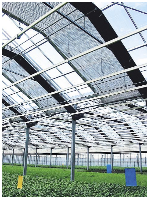
Die Energieschirme helfen bei der Einsparung von teurer Heizenergie.
