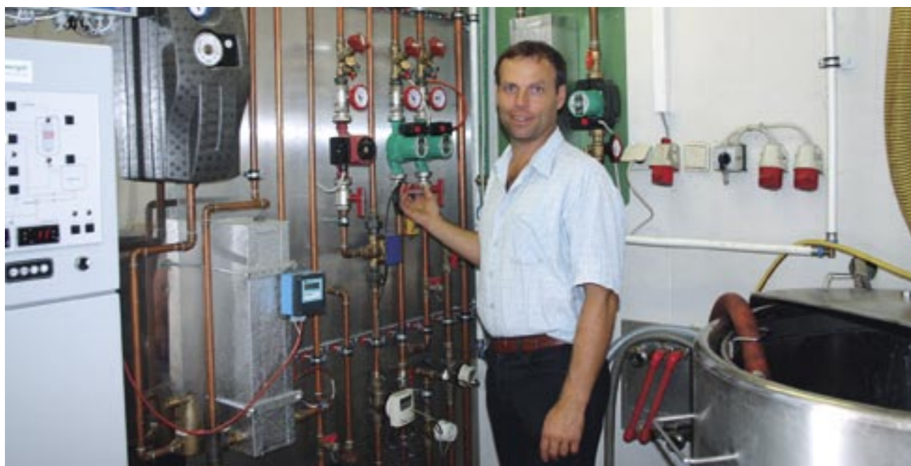
Der Hausherr an der zentralen Steuerungsanlage.
