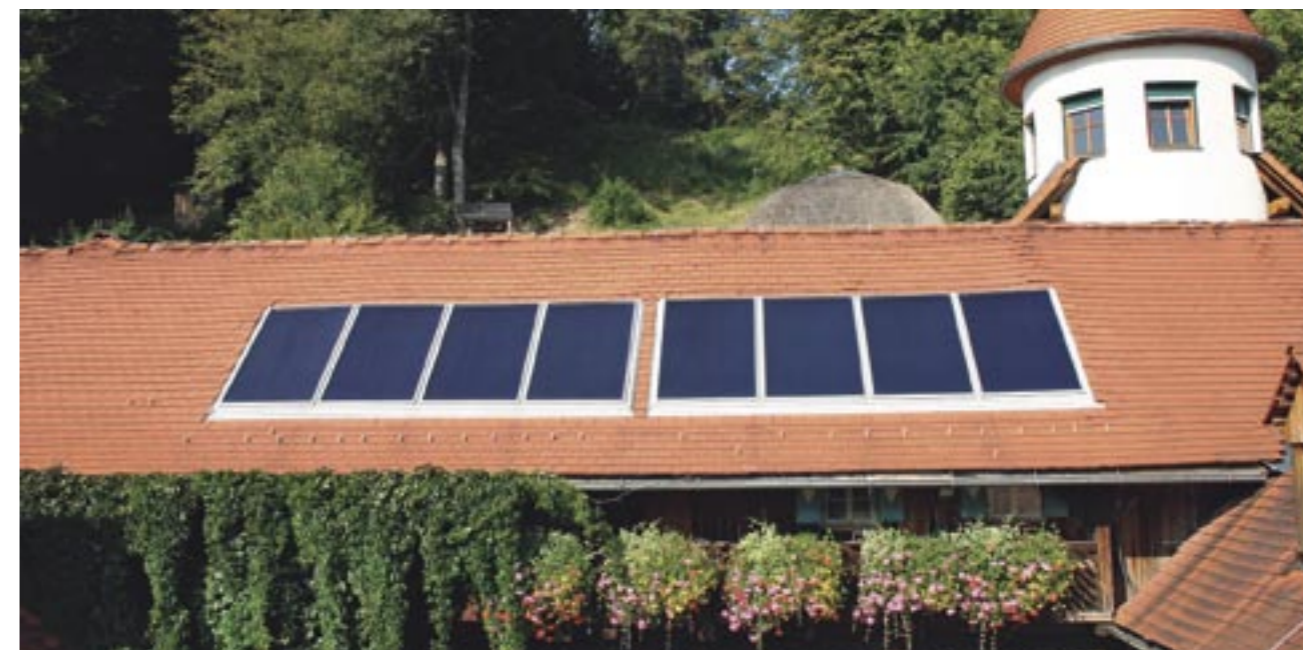
Die im Laufe des WIN-Projekts entwickelten Flachkollektoren sorgen für solarerhitztes Bier aus dem Hause Neuwirth.
