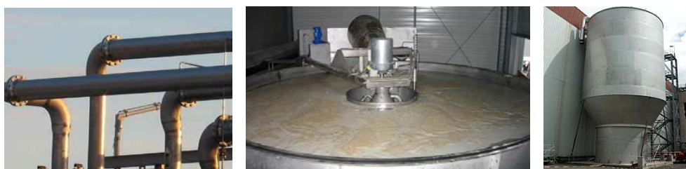
Abbildung 3-12: Rohrleitungen, Flotation (Kreislaufwasserreinigung), Stapelbütte (von links nach rechts)
