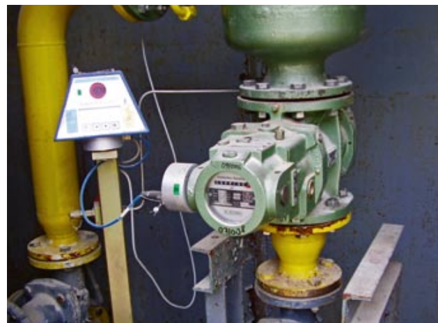
Der Gaszähler gab Informationen über den Verbrauch der Firma.
