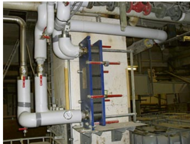
Wärmetauscher mit Kondensatleitung.
