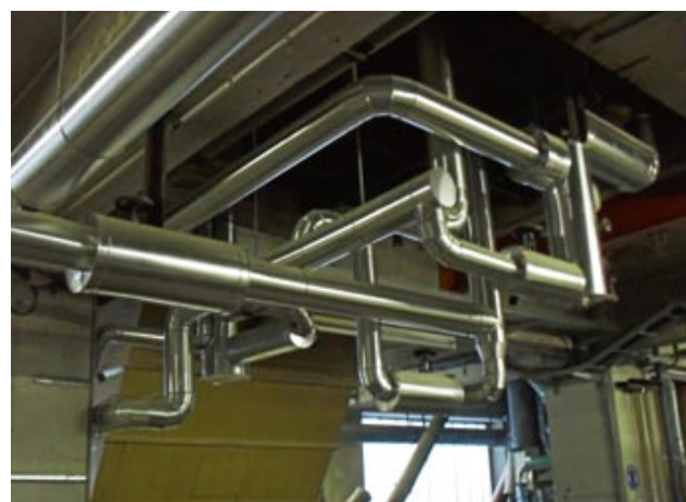
Durch die neuen Dampfleitungen werden die CO 2 -Emissionen jährlich um 68 Tonnen reduziert.
