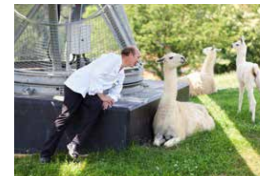
Ein schönes Schattenplätzchen für die Lamas, Schafe und Ziegen unter der Photovoltaik-Anlage.
