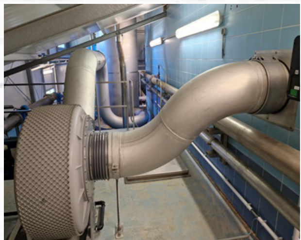
Neue Luftführung zum Rieselergebläse
